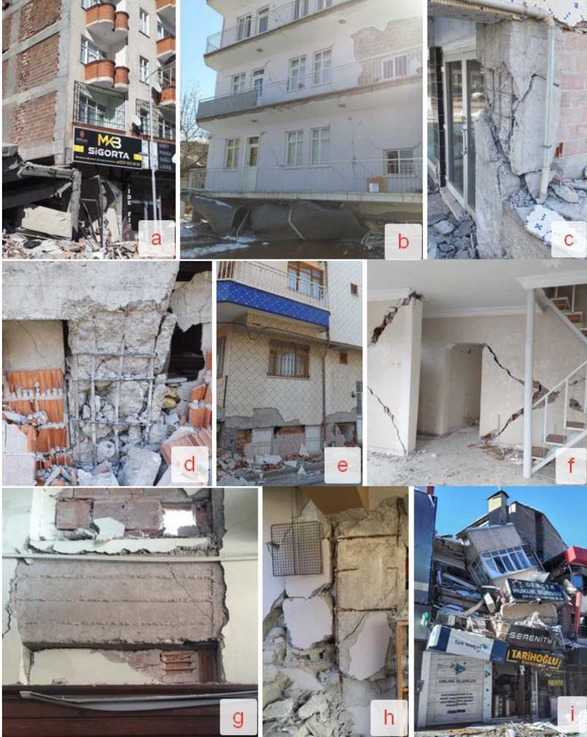
Görsel 2. BA yapılarda hasar örnekleri a) çarpışma hasarı; b) yumuşak kat hasarı; c) yetersiz betonarme; d) yetersiz betonarme; e) kısa kolon; f) dolgu duvar hasarları; g) kısa kiriş hasarı; h) yetersiz paspayı; i) yumuşak/zayıf kat
